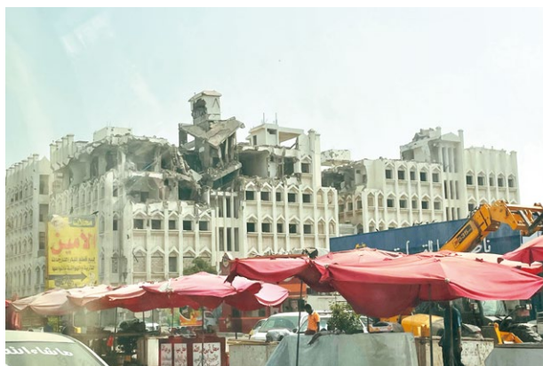
2015年の空爆によって破壊されたままになっているアデン市中心部の建物（イエメン）
