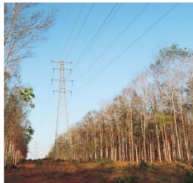
ゴムプランテーションと水力発電ダムの送電線
