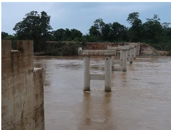
②⑧セーバンヒエン川に架かる橋は流失していた
