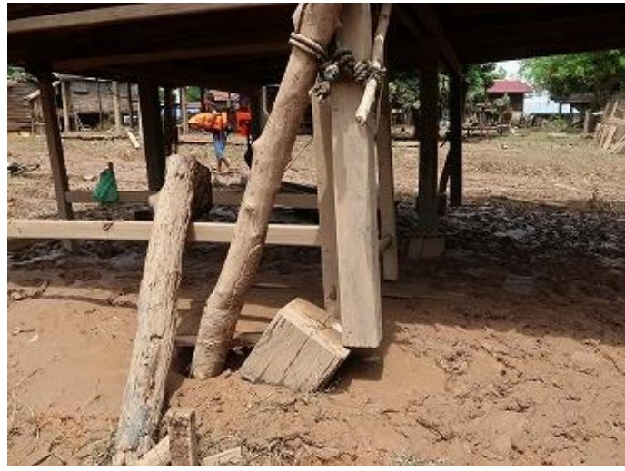
⑭支柱がずれた家屋（パシア村）
