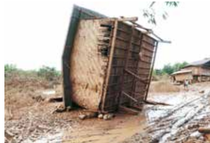
水害により倒壊した家屋
