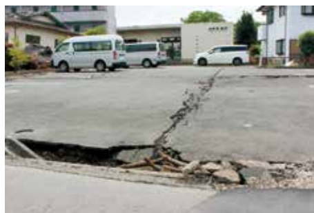
被害の大きかった益城町では地割れが目立った
