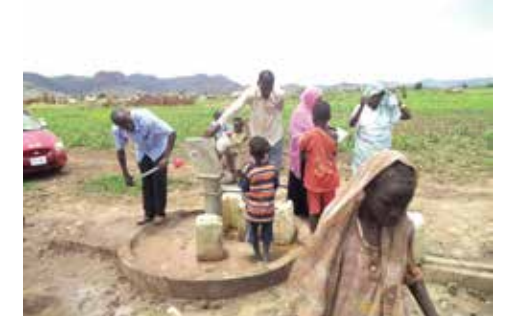
JVCが設置した手押しポンプ型井戸
